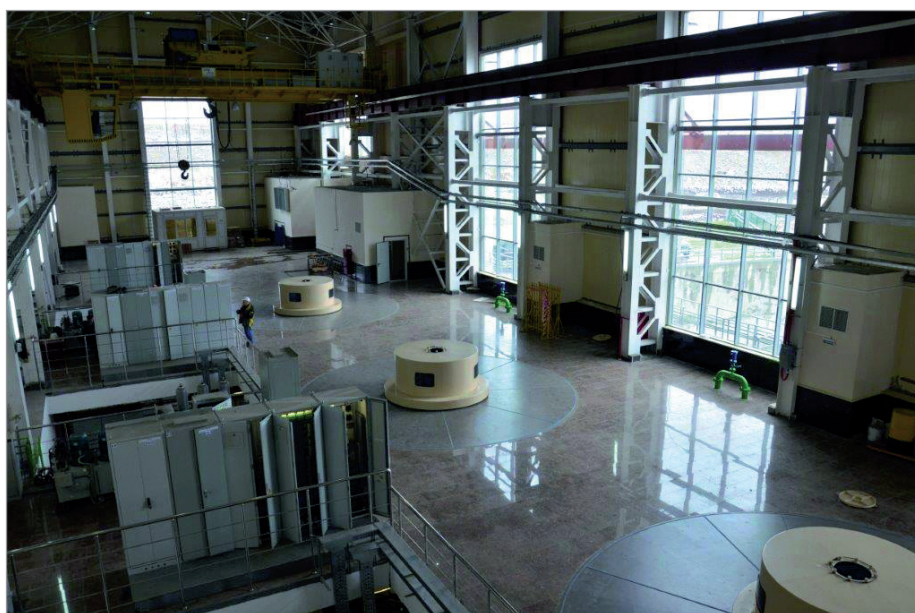
Рис. 9. Фотография машинного зала Зарагижской МГЭС на р. Черек
