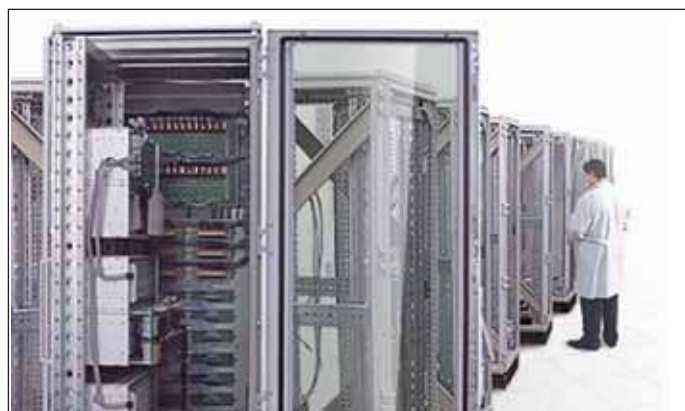
Рис. 1. Шкафы систем АСУТП
