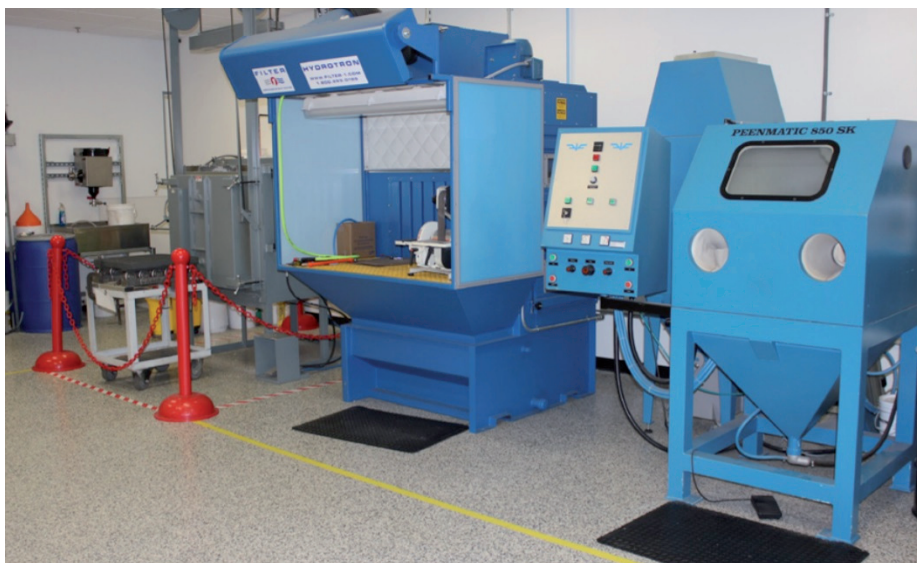
Зона постобработки с печью, столом с вытяжкой и дробеструйной камерой
